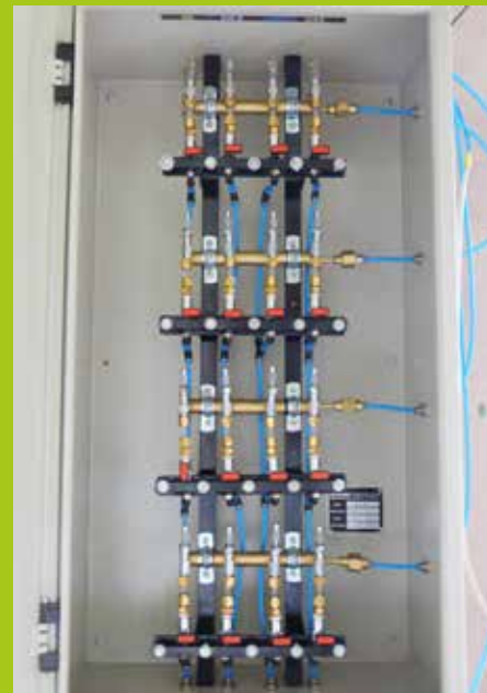
Figura 3. Tablero de mezcla de gases: aire, nitrógeno y dióxido de carbono.
